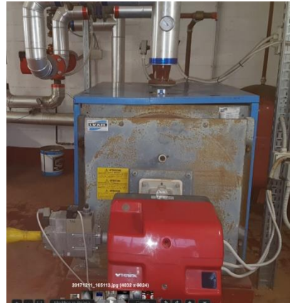
Figura 8.5 – Particolare della caldaia
